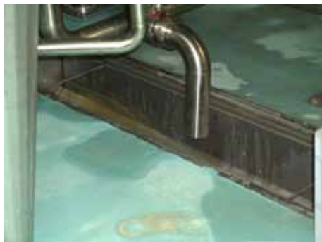
Дренажен канал осигуряващ голям капацитет на оттичане, ситуиран в зоната за бутилиране
