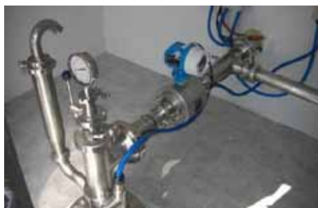
Вътрешен изглед на водочерпни съоръжения, проектирани с цел недопускане на замърсяване и за да се осигури надеждното вземане на проби
