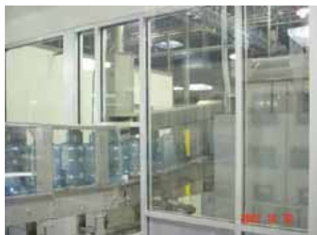
Покрити конвейери за предвижване на измити бутилки
