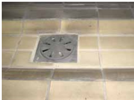
Отводнителна система, предодвратяваща събирането на вода по пода
